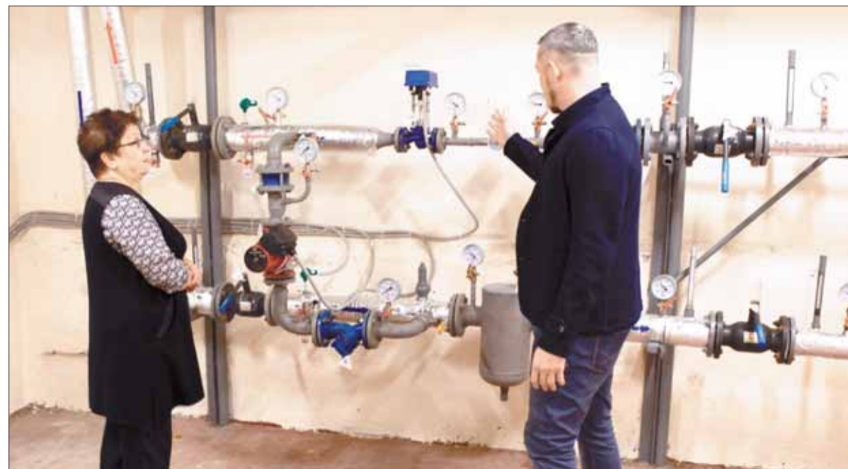
Школа №45, по словам директора Лидии ЕЛЬКИНОЙ , будет работать с «СК-Перспектива» и в другом ключе. Помимо эксплуатации трех установленных теплоузлов, компания займется обслуживанием внутренних систем теплоснабжения, водоснабжения и канализации.
