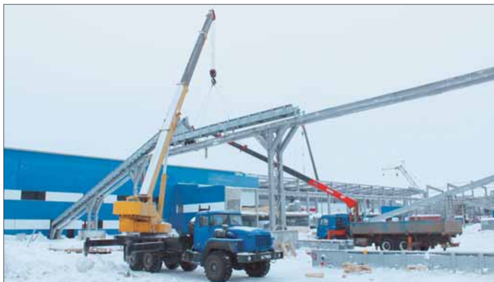
Лесопильный цех на ЛДК-3 построен с нуля. В паре сотен метров от старого возведено новое здание, смонтированы стол подачи, окорочный станок, лесопильные станки и линия сортировки сырых пиломатериалов.
